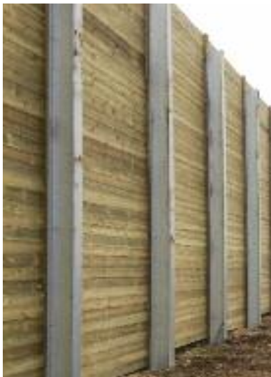
Mur Acoustique Autoroute avec poteaux IPN
